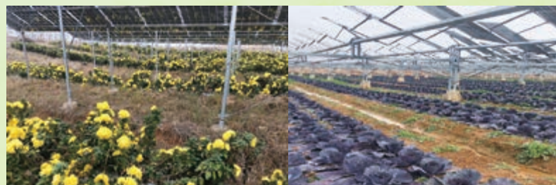
Xiaochang Solar Farm 孝昌光伏電站
